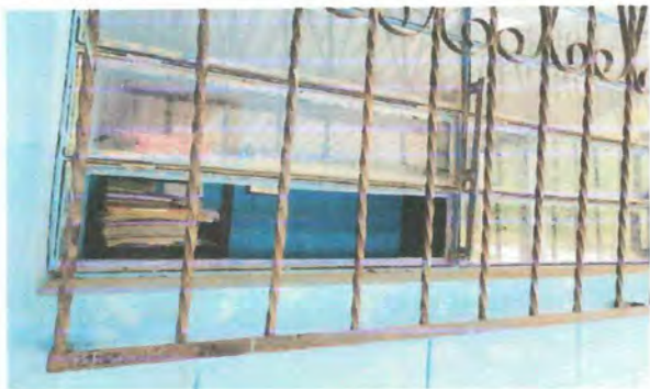
Foto 1: Módulo 1: Ventanas con vidrios quebrados en su totalidad, el cual se estará sustituyendo.
