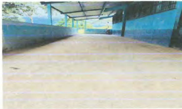
Foto 4: El piso del área del corredor del módulo 1, se encuentra en mal estado y que amerita intervención.
